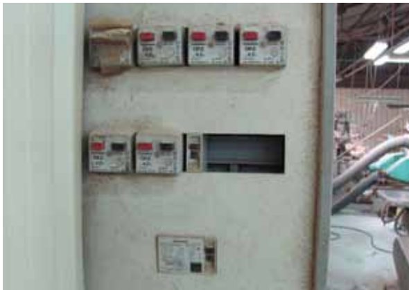
Figura 11 – Quadro de comando do sistema de ventilação de uma nave
