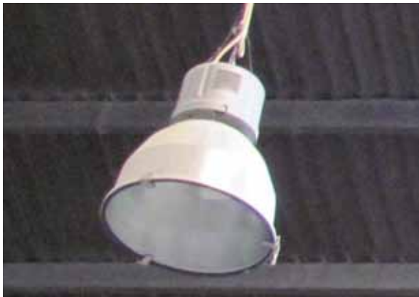
Figura 6 – Armadura provida de célula fotoelétrica
