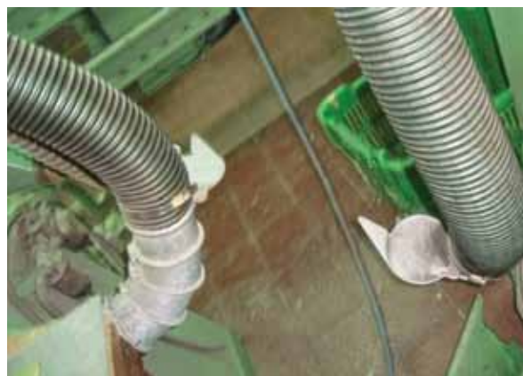
Figura 22 – Pormenor do registo de estrangulamento da conduta de ar
