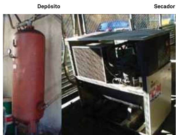
Figura 34 – Equipamentos auxiliares da central de ar comprimido
