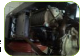
Figura 73 – Caldeira de gás natural
