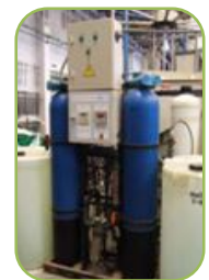
Figura 42 - Instalação de intercâmbio iónico para obtenção de água desmineralizada a partir da água da rede
