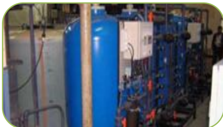
Figura 41 - Instalação de permuta iónica para reciclagem de águas residuais
