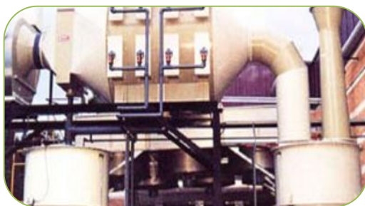
Figura 56 - Instalações de lavagem de gases
