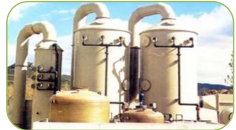
Figura 40 - Instalação de lavagem de gases
