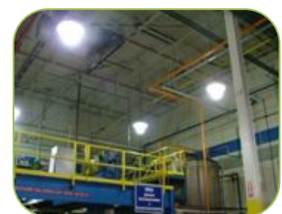
Figura 75 – Lâmpadas em nave industrial
