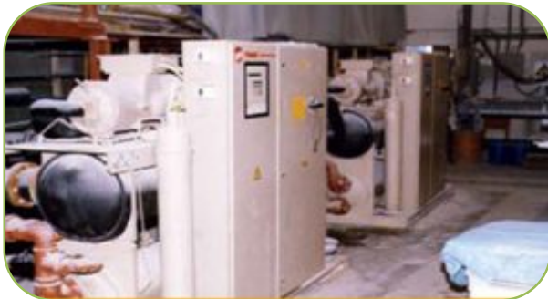
Figura 35 - Permutador de calor de uma central de anodização
