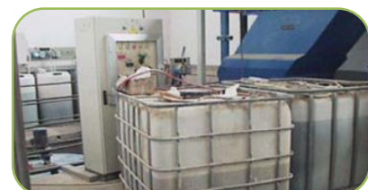
Figura 39 - Concentrados contaminados tratados por uma depuradora de águas residuais
