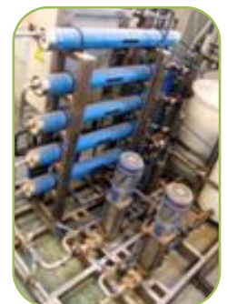
Figura 43 - Instalação de osmose inversa para produção de água de qualidade
