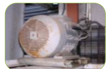
Figura 68 - Motor eléctrico em ambiente corrosivo
