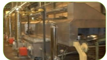
Figura 63 - Máquina de desgorduramento e lavagem de peças metálicas
