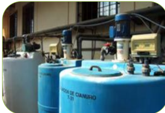
Figura 30 - Reactor de oxidação de cianeto de uma depuradora de águas residuais
