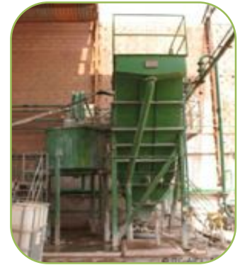
Figura 52 - Sedimentadores de lamelas
